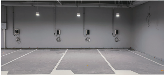
新能源車充電柱
