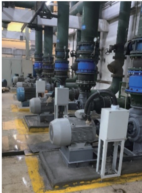
製冷站節能改造設備
